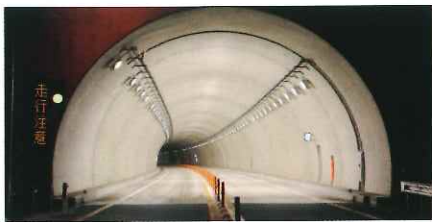
■トンネル照明機器
